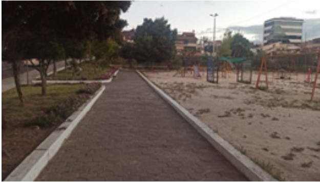
Figura 60 Caminerías en mal estado
