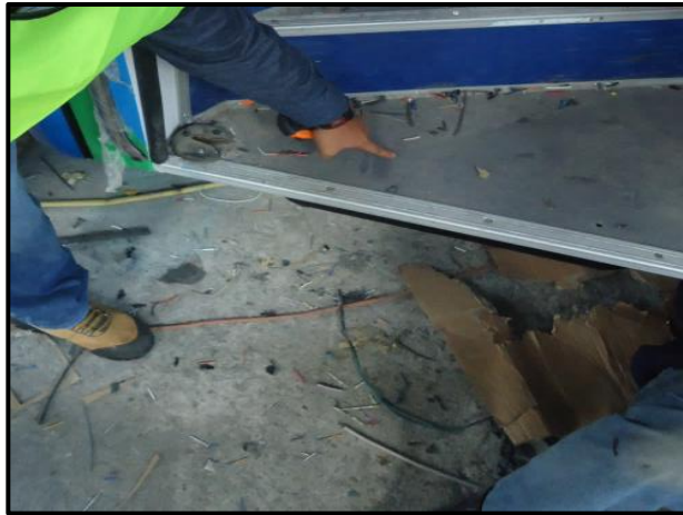
Figura N° 91: Verificación de la superficie resistente de los peldaños Elaborado por: Investigador
