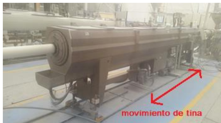
Figura 40: Tina de enfriamiento y Vacío
