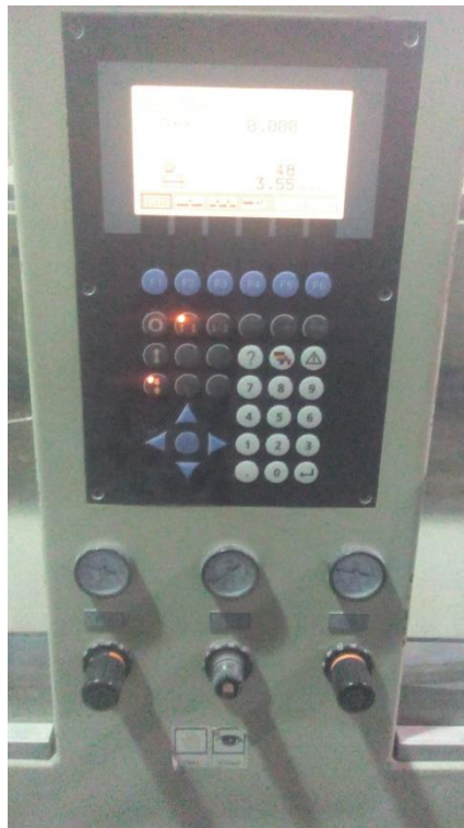
Figura 53: Regulador de Velocidades en el Halador y HMI
