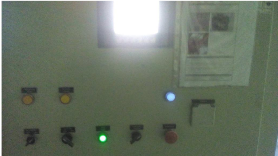
Figura 59: Panel de control de acampanador y señales
