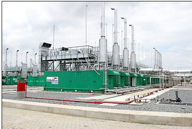
Figura 1. Central Termoeléctrica Quevedo, Ecuador
