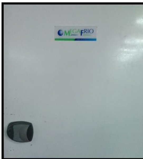
Figura N°. 16: Cuarto frío. Fuente: CORPICECREAM S. A.
