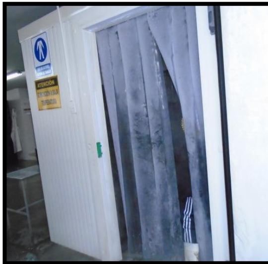
Figura N°. 38: Cuarto frío. Fuente: CORPICECREAM S. A.
