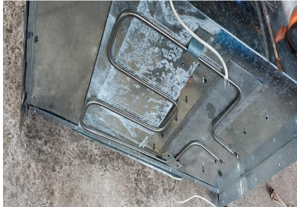
Figura 35 Implementación de resistencias.
