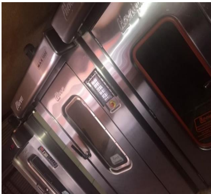
Imagen 6. Hornos y Cámara de Leudo
