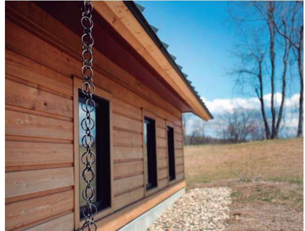
Filtración de agua de cubiertas Fuente. web
