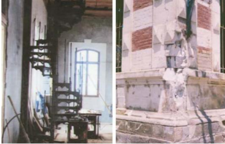
Figura 51. Deterioros de la edificación.
