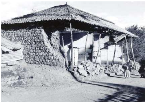
Imagen 4. Casa de adobe afectada por el terremoto de Ambato de 1949
