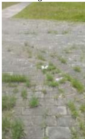
Figura 69. Crecimiento no controlado de vegetación
