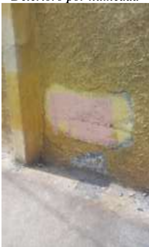
Figura 68. Deterioro por humedad
