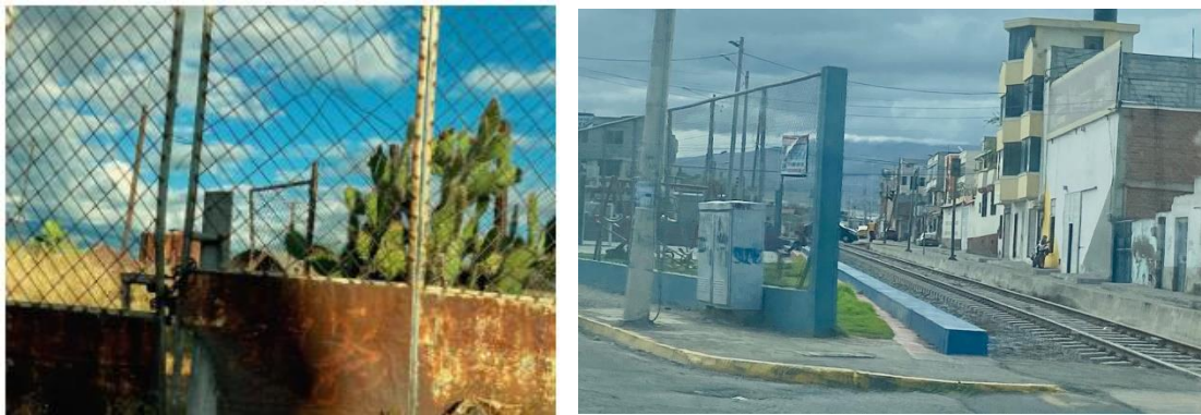
Imagen 19. Deterioro de los talleres del ferrocarril de la Calle B
