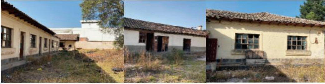
Imagen 23. Base de mantenimiento del tren, bloque 3
