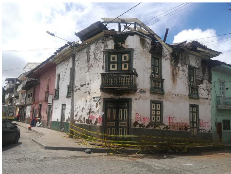
Ilustración 27: Estado MALO de la Vivienda Patrimonial. Elaboración: Propia
