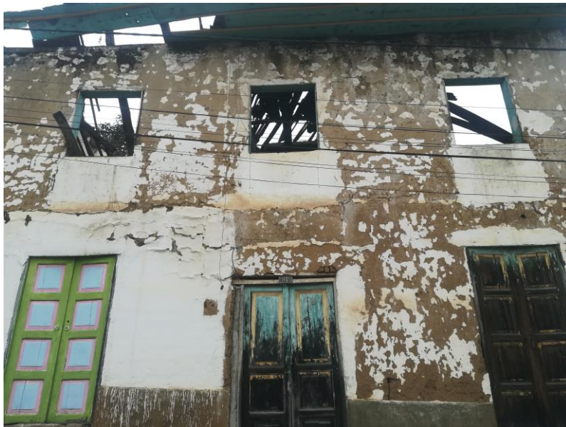
Ilustración 23: Deterioro de la Vivienda Patrimonial. Elaboración: Propia
