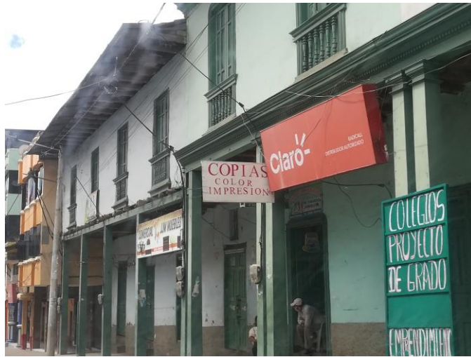
Ilustración 28: Rótulos comerciales que afectan la fachada de la Vivienda Patrimonial. Elaboración: Propia
