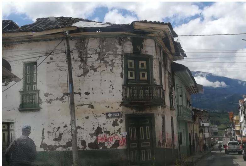
Ilustración 24: Deterioro de la Vivienda Patrimonial. Elaboración: Propia
