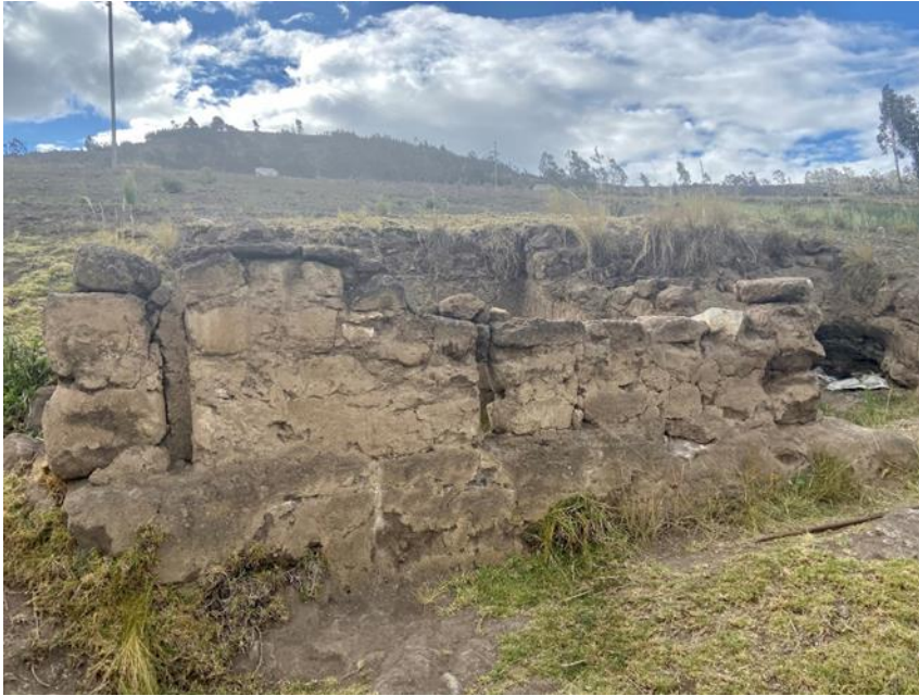
Figura 18. Muro de adobe Elaboración propia
