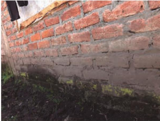
Erosion y humedad en paredes bajas exteriores
