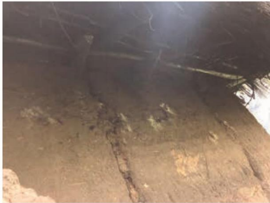
Unión entre muro de adobe y cubierta de paja con madera rolliza.
