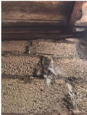
Salitre existente en paredes superiores cercanas a la cubierta.
