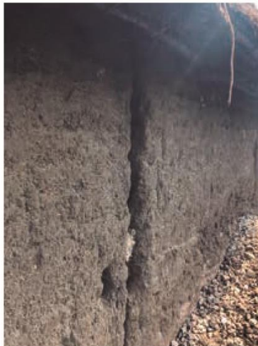
Grietas en paredes de exteriores de la vivienda.
