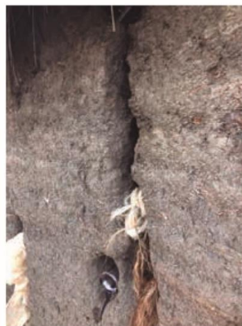
Erosión en paredes exteriores acompañada de grietas producidas por la edad de la vivienda.
