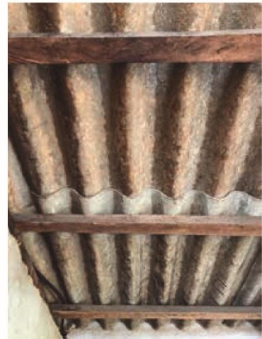
Desgaste de cubierta de fibrocemento provocando humedad al interior de la vivienda.
