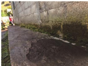
Humedad existente en paredes exteriores de la vivienda, provocando erosión del piso de hormigón por exceso de humedad.
