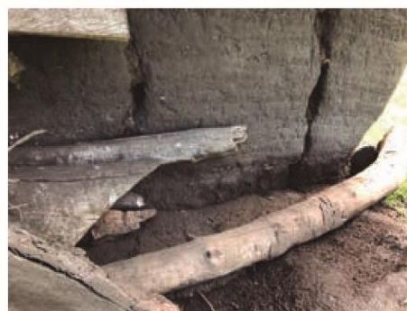
Erosión en base del muro de adobe con grietas en los muros.
