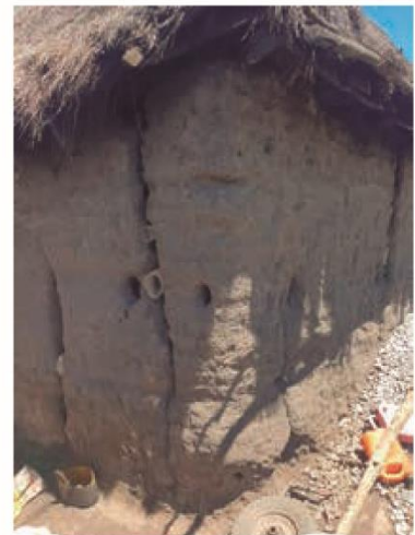
Grietas y perforaciones en paredes de exteriores de la vivienda.
