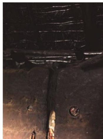
Erosión de materiales constructivos de la vivienda , cubierta llena de hollín producida por la cocina de leña.
