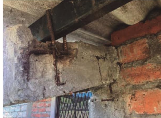
Erosion en vigas de hormigon y corrosion en estructura de metal de cubierta.
