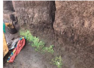
Humedad existente en pared baja de la vivienda.
