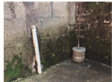
Humedad existente en paredes exteriores de la vivienda que se propagan de forma ascendente.
