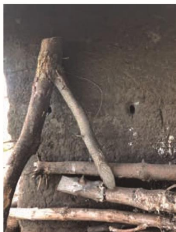
Perforaciones en muros de adobe.
