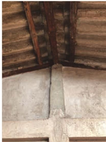
Erosión de la estructura de madera de la cubierta.
