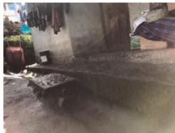
Erosión muy notable en materiales de la vivienda producidos por el exceso de humedad.
