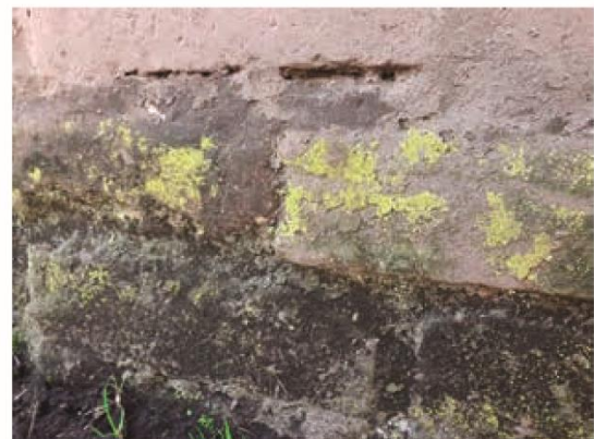
Humedad existente en paredes inferiores externas de la vivienda.
