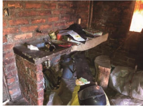
Cocina en mal estado por falta de uso, se utiliza como lugar de almacenamiento de enceres.
