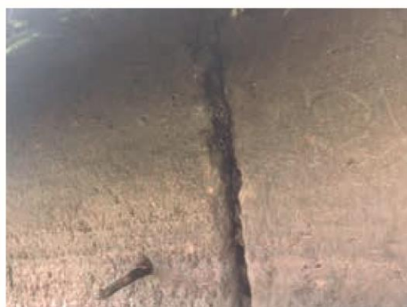
Grietas en muros de adobe.
