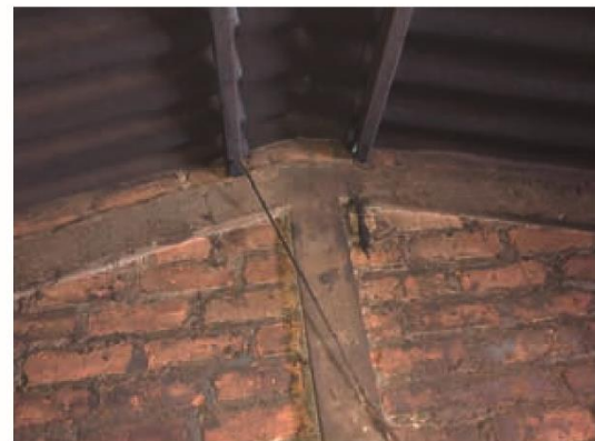
Afectación en cubierta de planchas de fibrocemento y estructura de metal por el hollín.
