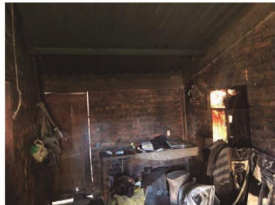
Afectación por el hollín en el interior de la vivienda.
