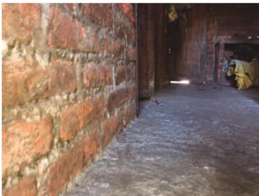
Erosion en piso de hormigon interno de la vivienda
