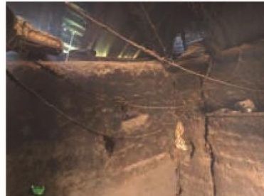
Erosión y grieta de paredes internas producidas por el hollín y por el tiempo en la vivienda.
