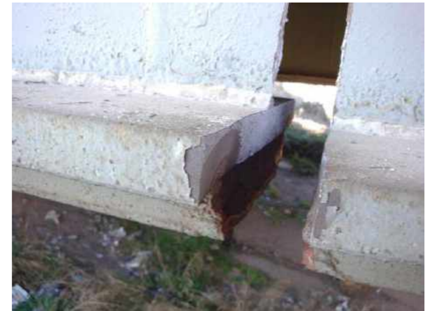
Imagen 21 Impactos y sobrecargas
