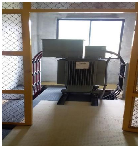
Imagen 8: Transformador de servicios 220 VAC
