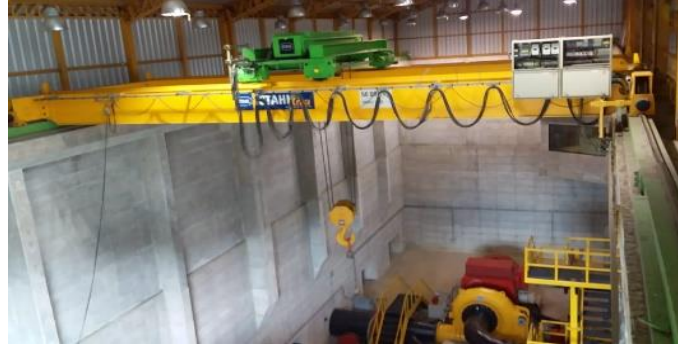
Imagen 22: Puente grúa Fuente: Central Hidroeléctrica Sibimbe
