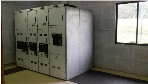
Imagen 7: Control principal (interruptores de potencia)
