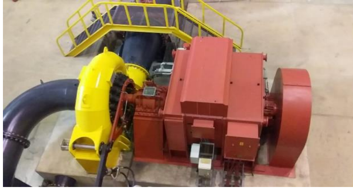
Imagen 24: Turbina Francis y generador de 8.5 MW
