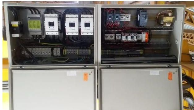
Imagen 23: Tablero eléctrico del puente grúa Fuente: Central Hidroeléctrica Sibimbe
