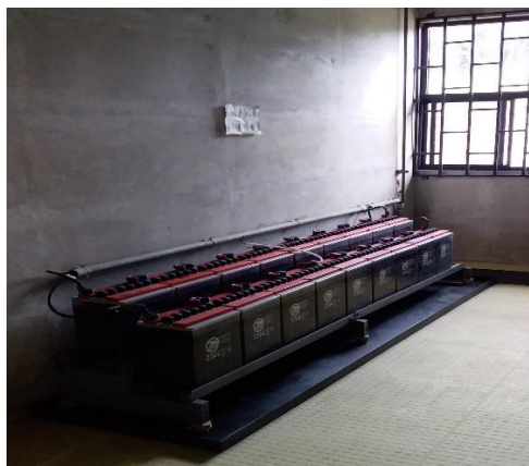
Imagen 6: Banco de baterías
