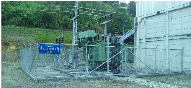
Imagen 12: Subestación o patio de maniobras Fuente: Central Hidroeléctrica Sibimbe
