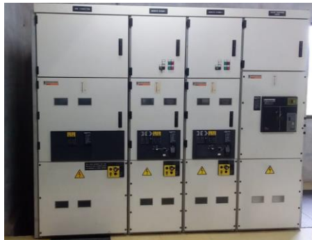
Imagen 19: Interruptores de potencia Fuente: Central Hidroeléctrica Sibimbe
