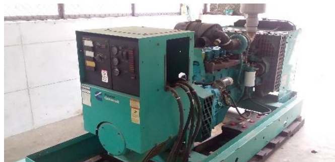
Imagen 25: Generador de emergencia Fuente: Central Hidroeléctrica Sibimbe
