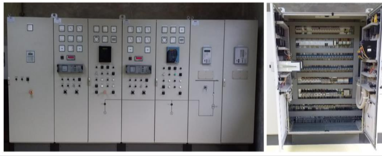
Imagen 17: Tablero eléctrico de control Fuente: Central Hidroeléctrica Sibimbe
