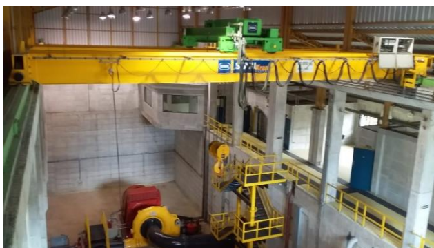
Imagen 10: Área de turbinas y Puente grúa
