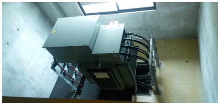
Imagen 20: Transformador de servicios de 220 VAC Fuente: Central Hidroeléctrica Sibimbe
