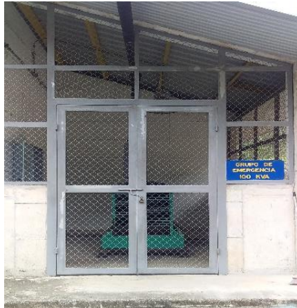
Imagen 11: Generador de emergencia Fuente: Central Hidroeléctrica Sibimbe
