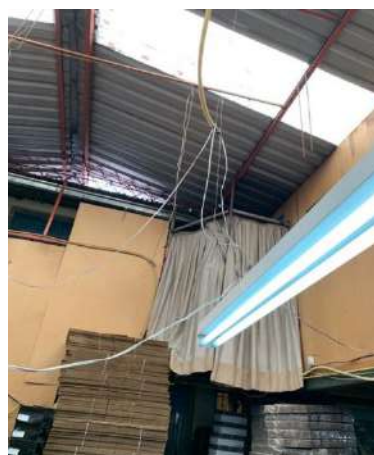
Imagen 4. Conexiones eléctricas Elaborado por: Pazmiño (2019)
