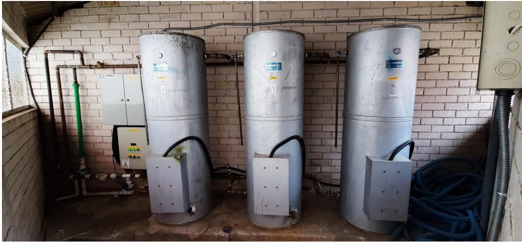
CALENTADORES DE AGUA DEL CASINO CENTRAL
