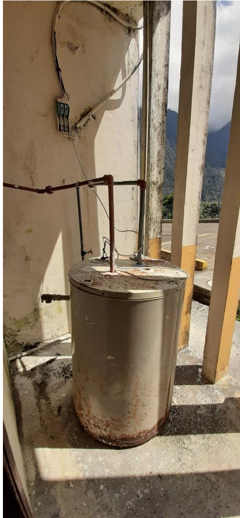
EQUIPOS EN MAL ESTADO
