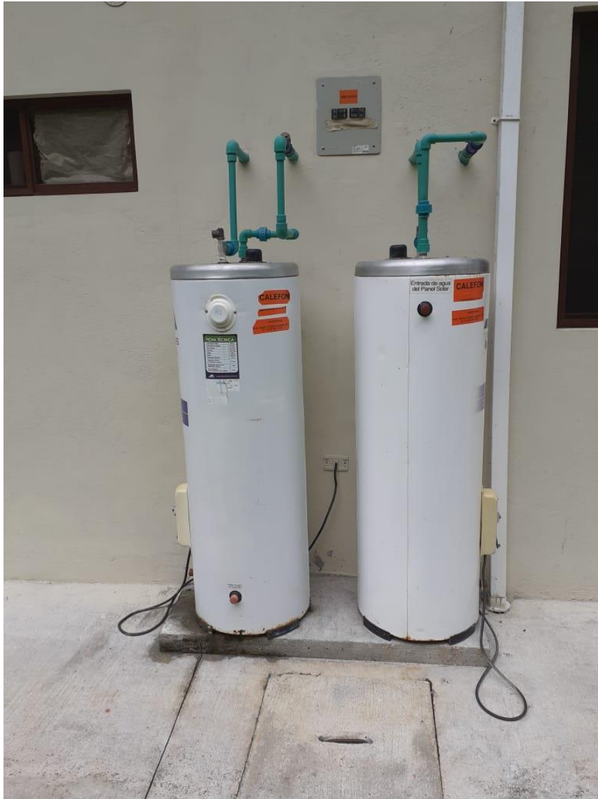
CALEFONES DETERIORADOS Y EXPUESTOS A LA INTERPERIE
