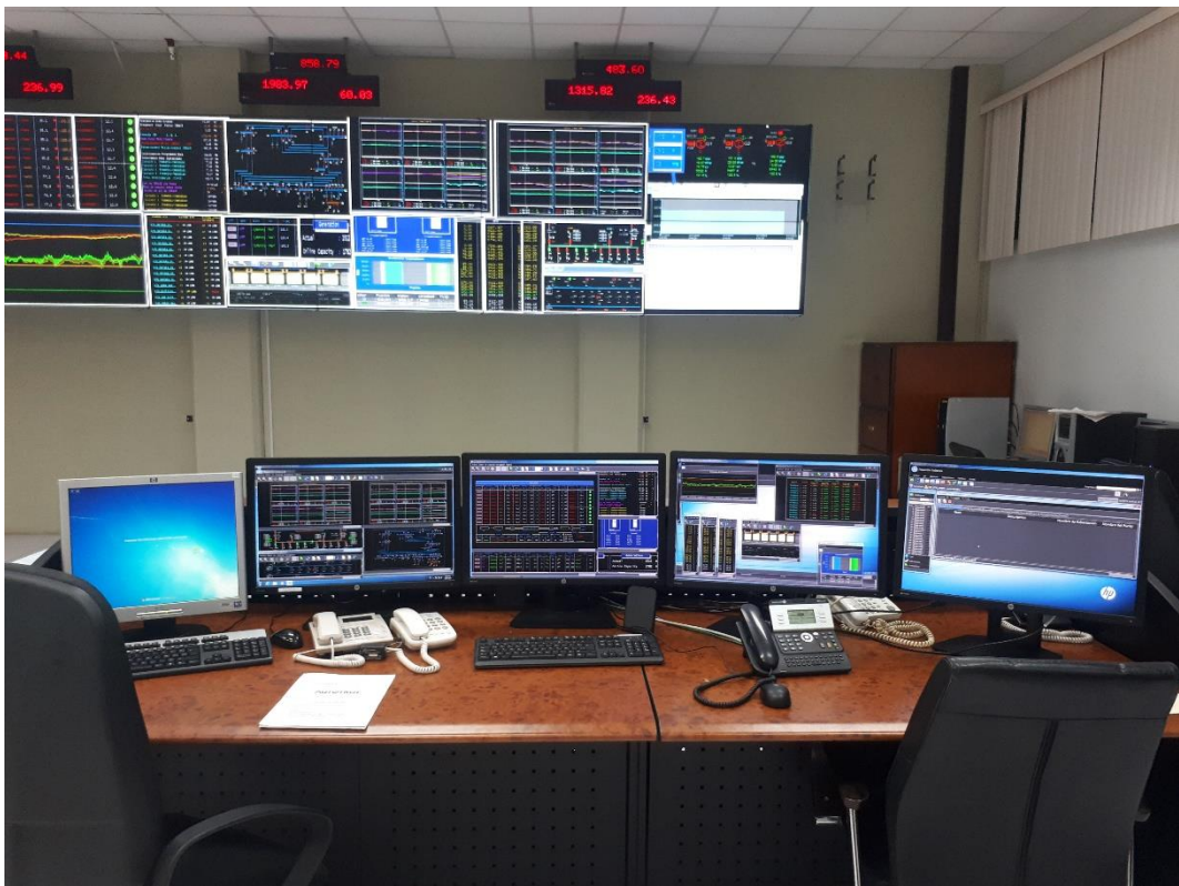
VISTA CENTRO CONTROL DE GENERACIÓN
