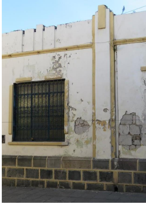
Fotografía 102. Muro en proceso de deterioro Fuente: Taipe, Santiago (2020)
