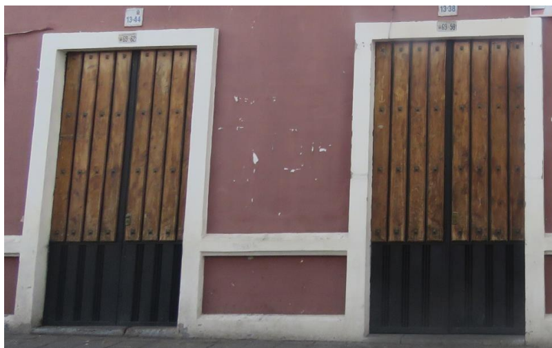
Fotografía 88. Herrajes en puertas de madera Fuente: Taipe, Santiago (2020)
