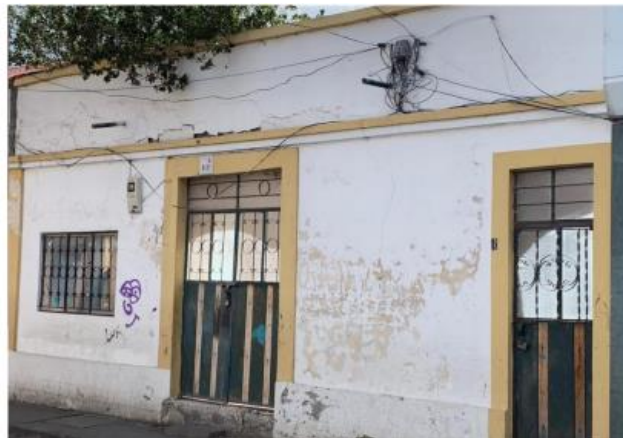
Fotografía 106. Fachada en proceso de deterioro Fuente: Taípe, Santiago (2020)
