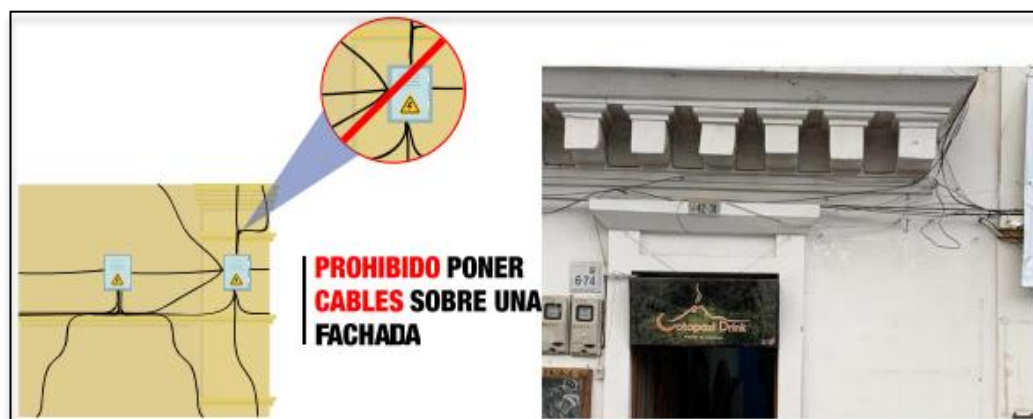
Gráfico 65. Inadecuada intervención en instalaciones Elaborado por: Taipe, Santiago (2020)
