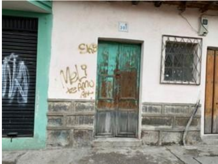
Fotografía 114. Fachada en deterioro Fuente: Taipe, Santiago (2020)
