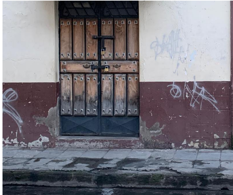
Fotografía 100. Humedades en fachadas Fuente: Taipe, Santiago (2020)
