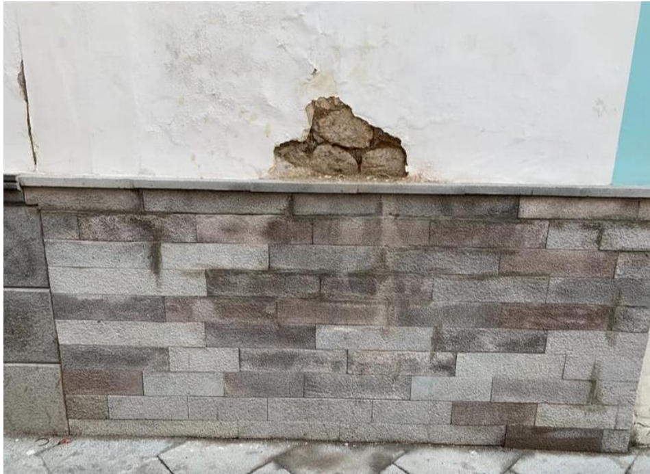
Fotografía 105. Presencia de humedad Fuente: Taipe, Santiago (2020)
