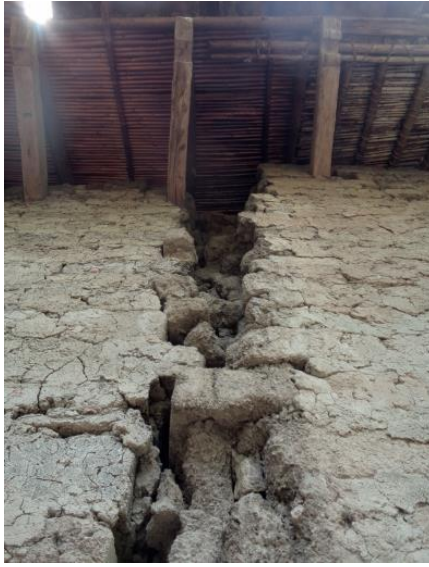
Ilustración 24. Grieta muro sur Casa Hacienda Shuracpamba Fuente: http://arqarqt.revistas.csic.es
