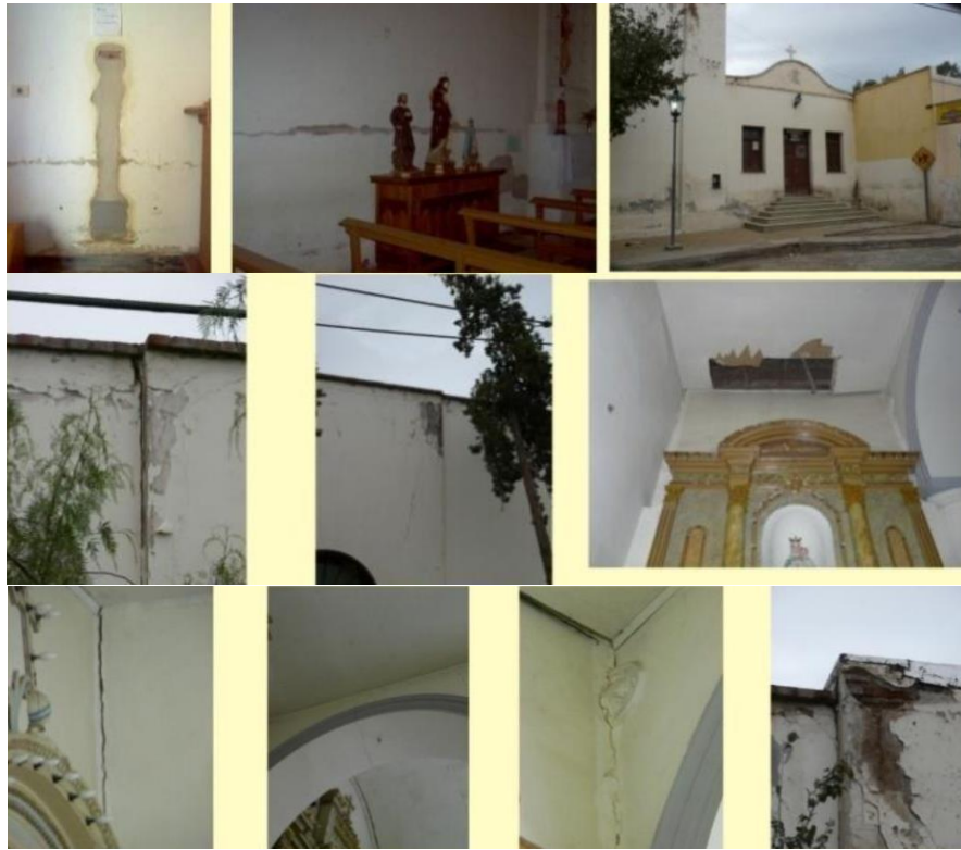
Ilustración 26. Defectaciones de la Iglesia San José de Jáchal
