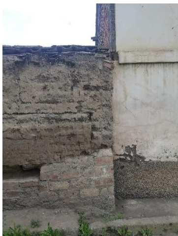
Ilustración 7: Deterioro urbano en la parroquia de Quimiag
