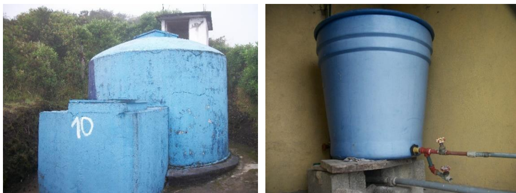
Imagen No. 8 y 9 Tanque de almacenamiento y tratamiento
