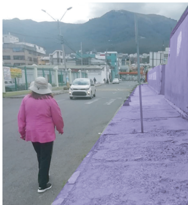
Figura 3. Muro ciego y deterioro de la acera. Foto: Elisa Puga.
