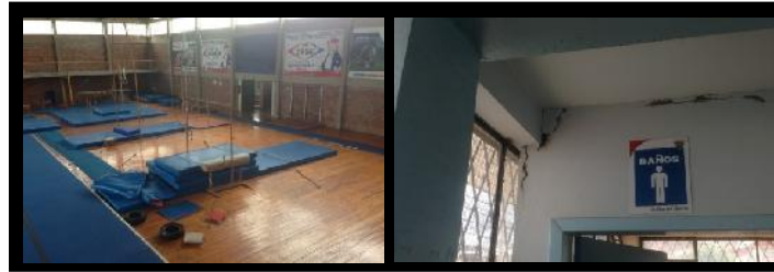
Imagen 64: Fotografía estado actual del espacio físico de entrenamiento de gimnasia en el cual presenta deterioro y las dos disciplinas deportivas funcionan en un mismo sitio.
