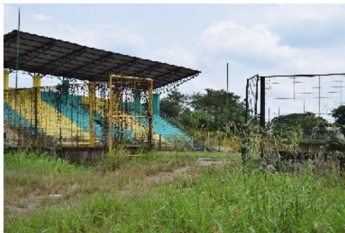
Imagen 78: Estado en que se encontraba el equipamiento deportivo en Gramalote Colombia.
