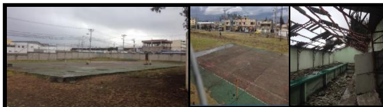
Imagen 62: Fotografía estado actual del espacio físico de entrenamiento de Tenis de Campo, se aprecia el deterioro de la infraestructura y el abandono de las canchas de juego.
