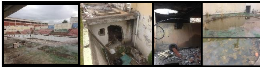
Imagen 61: Fotografía estado actual del espacio físico de entrenamiento de natación, se aprecia los desechos peligrosos y el abandono total del equipamiento por estar en estas condiciones.
