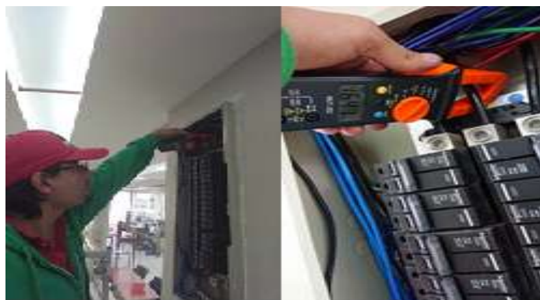
Imagen No 10: Alim Tablero de alimentación Ingeniería Industrial Elaborado por: El Investigador
