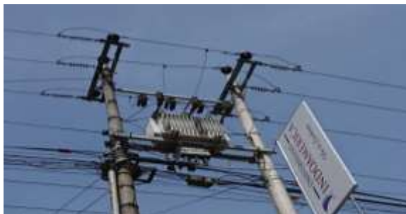
Gráfico No 12: Transformador de distribución
