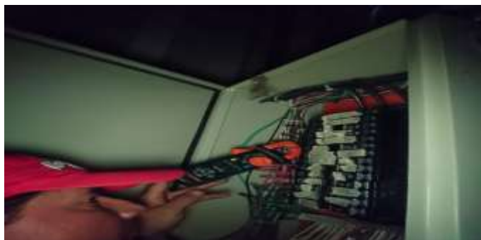
Imagen No 15: Tablero de alimentación piso 2: secretaria Elaborado por: El Investigador
