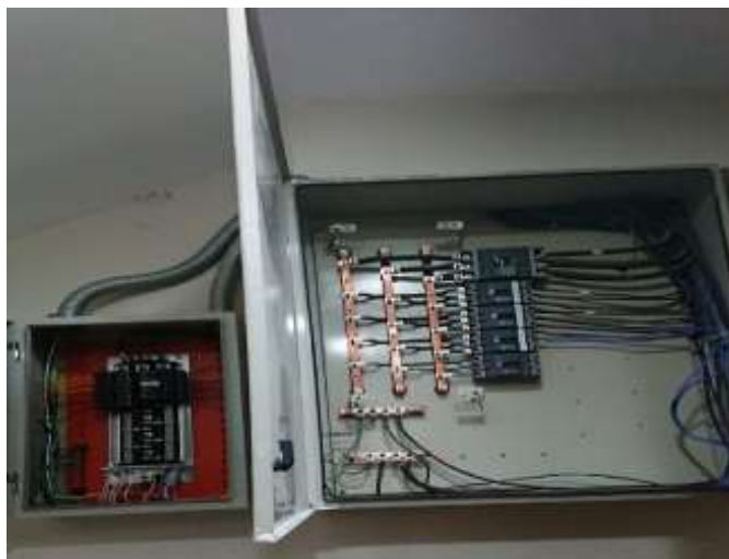
Imagen No 8: Tablero de distribución principal auditorio Elaborado por: El Investigador
