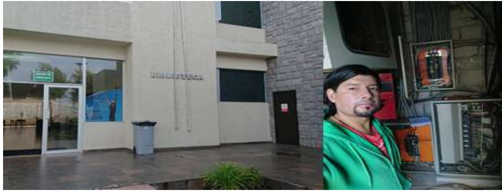
Imagen No 14: Tablero de alimentación piso 1: biblioteca, dirección semipresencial Elaborado por: El Investigador
