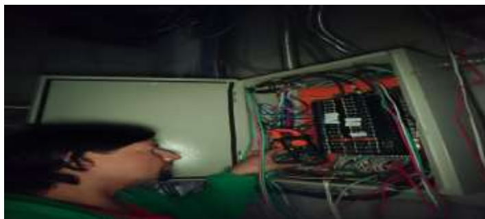
Imagen No 4: Tablero de alimentación piso 2, aulas B1-B11 Elaborado por: El Investigador
