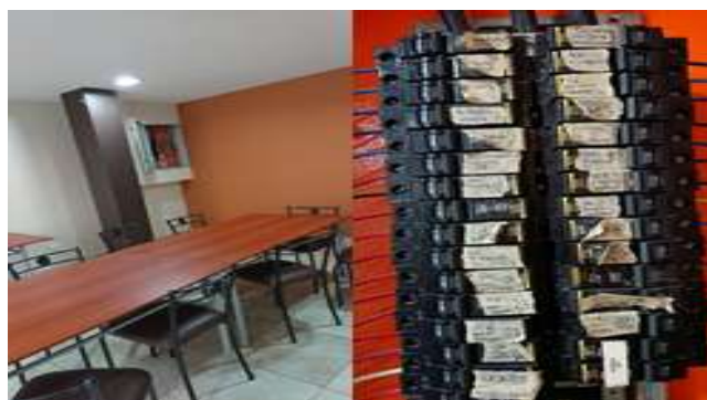
Imagen No 18: Tablero de alimentación bar el campus Elaborado por: El Investigador
