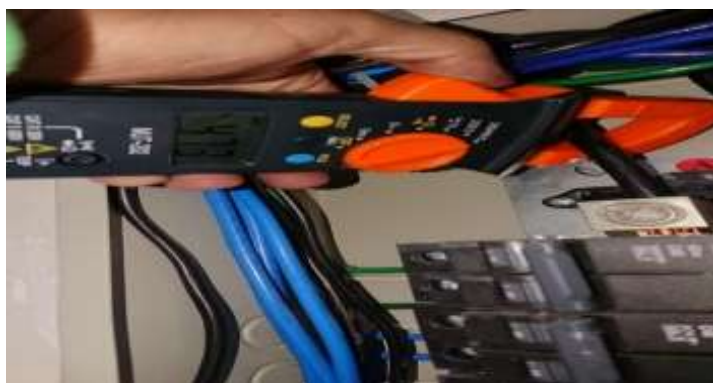
Imagen No 5: Tablero de alimentación piso 3, aulas C1-C12
