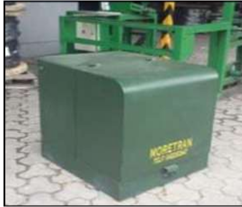
Gráfico No 16: Transformador de pedestal
