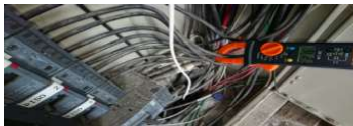
Imagen No 13: Tablero de distribución principal edificio 1 Elaborado por: El Investigador
