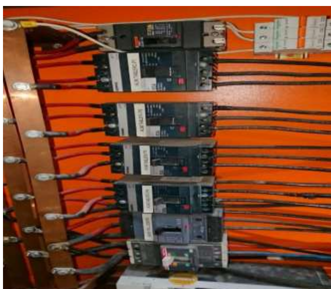
Imagen No 2: Tablero de distribución edificio Bloque A
