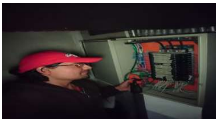
Imagen No 6: Tablero de alimentación piso 4, aulas D1-D8
