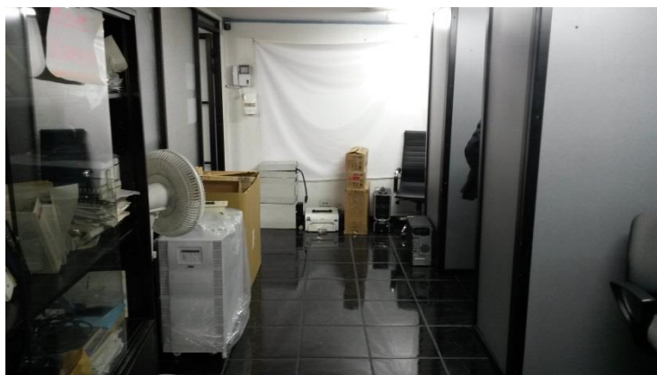
Figura 11: Centro de cómputo
