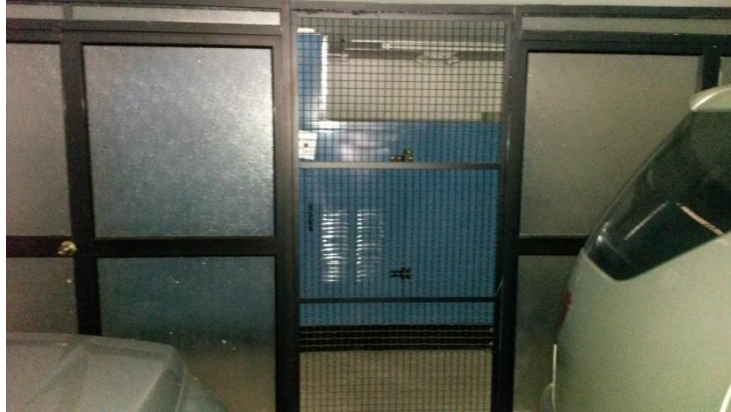
Figura 12: Sala de generador
