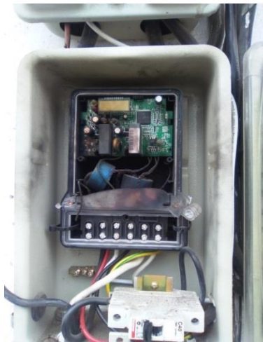
Figura 19: Medidor dañado Fuente: Investigación propia Elaborado por: Wilson Gualotuña.
