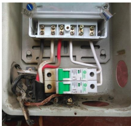
Figura 16: Cables recalentados dentro de la Caja Anti hurto
