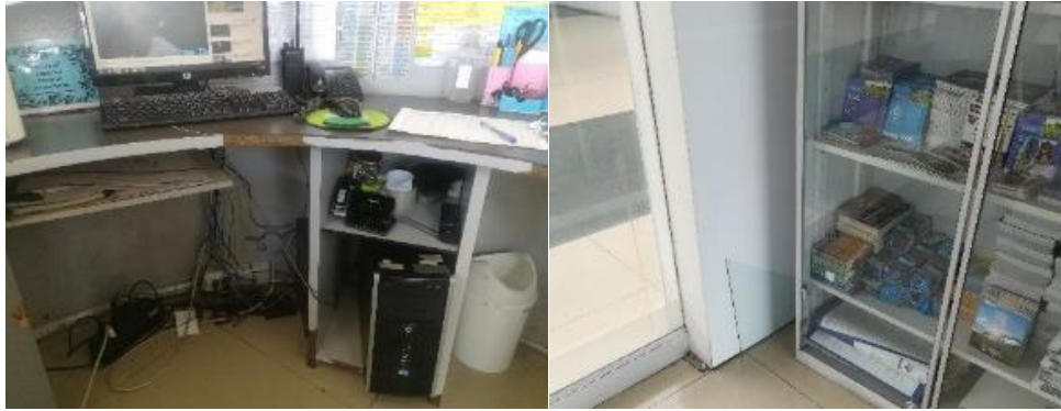
Ilustración 9: Cables y suciedad parte baja del counter; vidrio roto detrás de la vitrina. Elaborado por: Autor.
