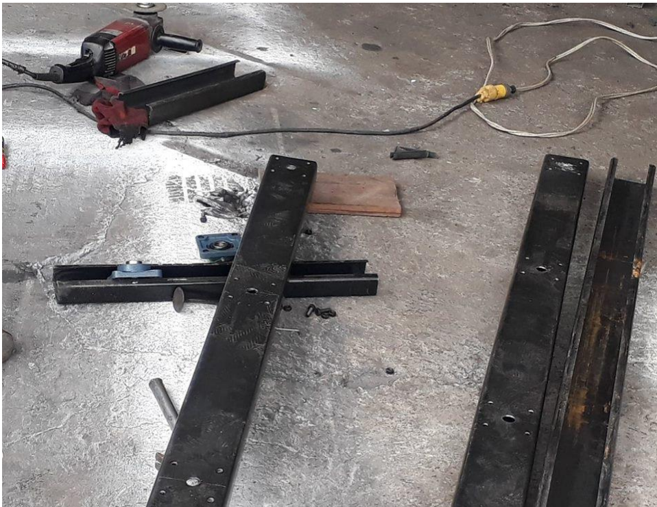
Anexo 8 Colocación de las chumaceras de media pulgada en el perfil de la estructura.
