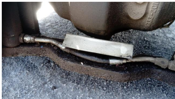
Figura N° 7: Derrame de Baoli Fuente: Grupo JET Elaborado por: La Investigadora
