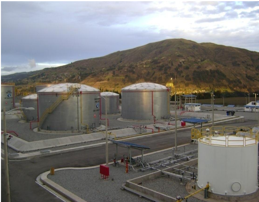
Figura No. 5: Tanques del Terminal de Productos Limpios Riobamba EP PETROECUADOR
