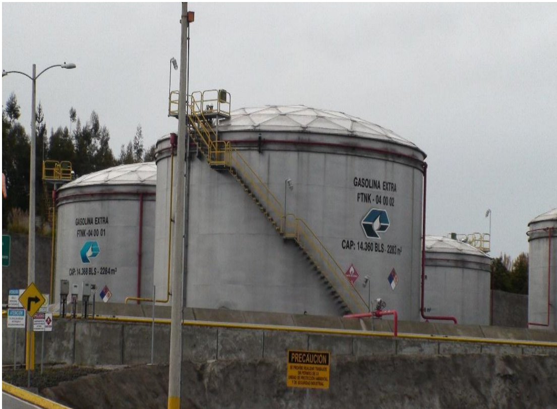
Figura No. 7: Tanques de Almacenamiento del Terminal de Productos Limpios Riobamba de EP Petroecuador Fuente: Investigación de campo en el Terminal de Productos Limpios Riobamba EP Petroecuador, 2017; (Petroecuador, 2018)
