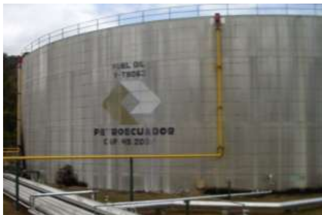
Figura 11 Señalización en la Pared de un tanque vertical en mal estado
