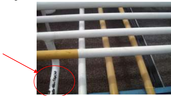
Figura 15 Pintura en mal estado sobre las tuberías en el interior de una instalación.
