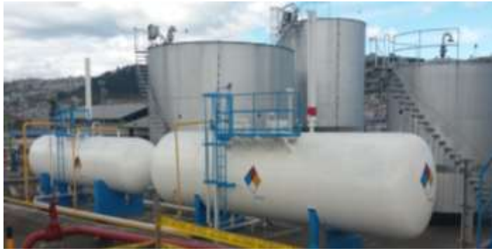
Figura 10 Tanques horizontales nuevos sin adecuada identificación
