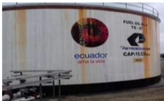
Figura 13 Pintura en mal estado sobre el tanque vertical y propagandas.
