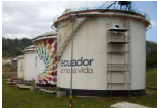
Figura 18 Diferencia de identificación y señalización en tanques de almacenamiento
