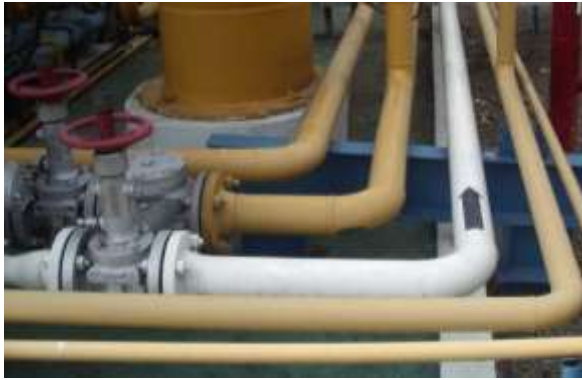
Figura 14 Flecha de dirección en una tubería en el interior de la instalación Oyambaro
