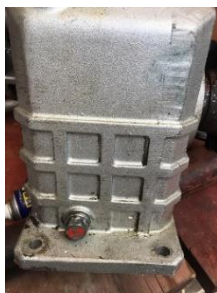
Figura 97: Caja de aceite de la bomba contra incendios
