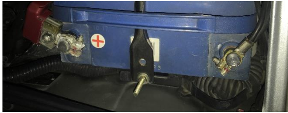
Figura 87: Terminales positivo y negativo de la batería.
