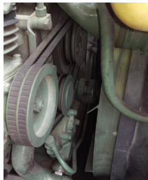
Figura 82: Bandas y tensores del motor
