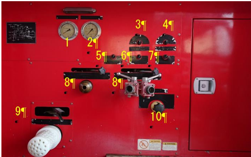
Figura 122: Panel 2 de mandos y manómetros de la bomba Morita
