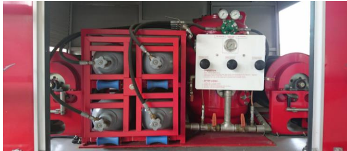
Figura 49: Tanques de CO 2 y tanque PQS
