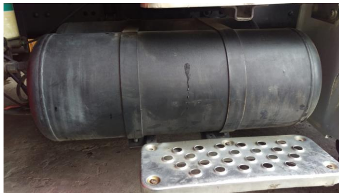
Figura 85: Tanque de combustible
