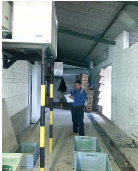
Figura 10 : Toma de datos en los equipos de refrigeración.
