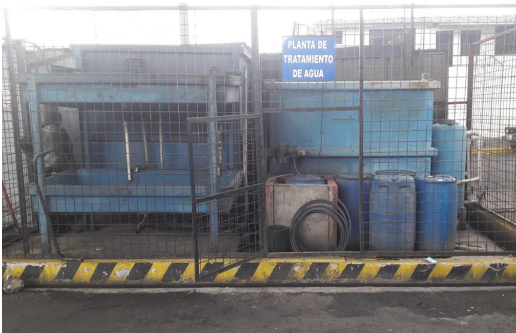
Figura N° 25: Planta de tratamiento de aguas de lavado.
