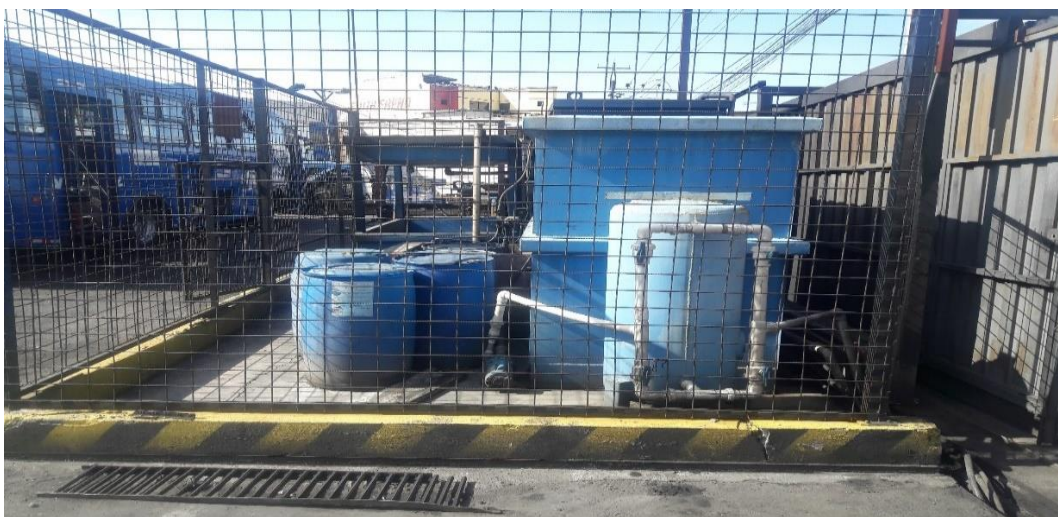
Figura N° 26: Filtro de descarga de carbón activado.
